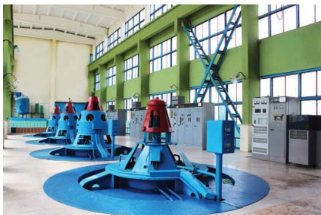
Рис. 5. Насосно-силовое оборудование внутри насосной станции Приволжской ОС
